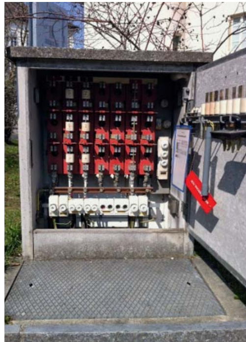
Verteilkabine Gemeindehaus vor dem Umbau ...
